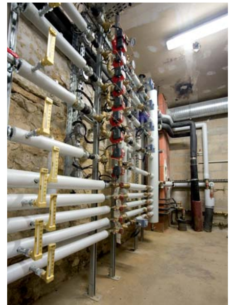
Les deux boucles secondaires de chauffage alimentent une douzaines de sous-stations qui distribuent l'énergie aux différents émetteurs selon leur régime de température spécifique.
