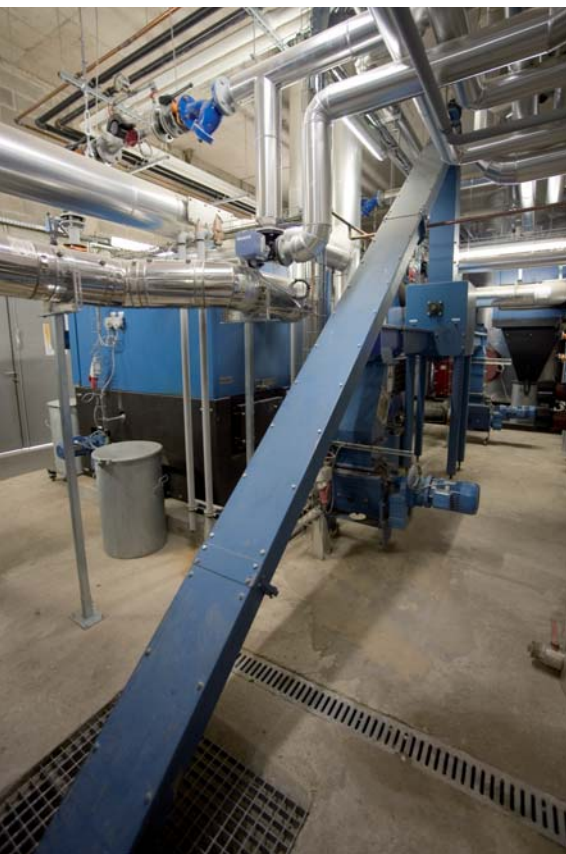
Une vis conduit les plaquettes du silo vers un répartiteur entre les deux chaudières. Cette distribution est commandée par les besoins thermique de l'installation.
