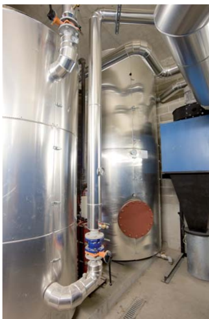
L'eau du circuit primaire des chaudières est stockée dans un tampon de 6 m 3 de manière à lisser la puissance des chaudières. Ce ballon est constamment maintenu à 85-90 °C.
