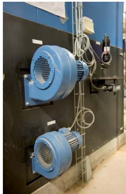
La gestion technique pilote aussi le rendement de l'installation par introduction d'air primaire et secondaire dans le foyer.
