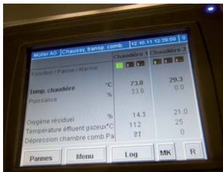
Le tableau de commande de la chaudière permet de lire l'état précis de la puissance et la combustion de chaque générateur.
