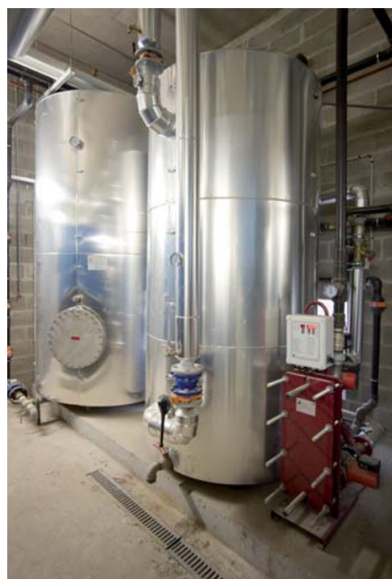
Au dernier plan, le ballon de stockage de l'eau chaude solaire (5 m 3 ) issue des 96 m 2 de capteurs thermiques ; au premier plan, le ballon (4 m 3 ) de stockage d'eau chaude produite par les chaudières bois et destiné à assurer l'appoint d'ECS.
