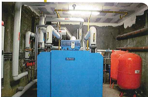
Vue sur la chaufferie
