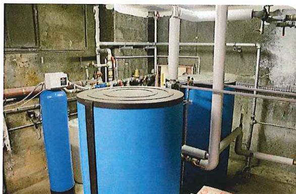
Ballons d'eau chaude
